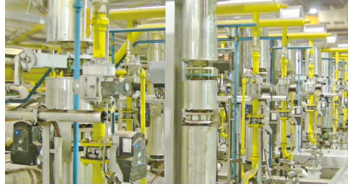
Hubbalkenofen mit Deckenbeheizung
